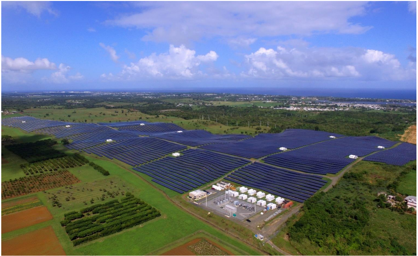
Parque solar Infinigen Oriana
