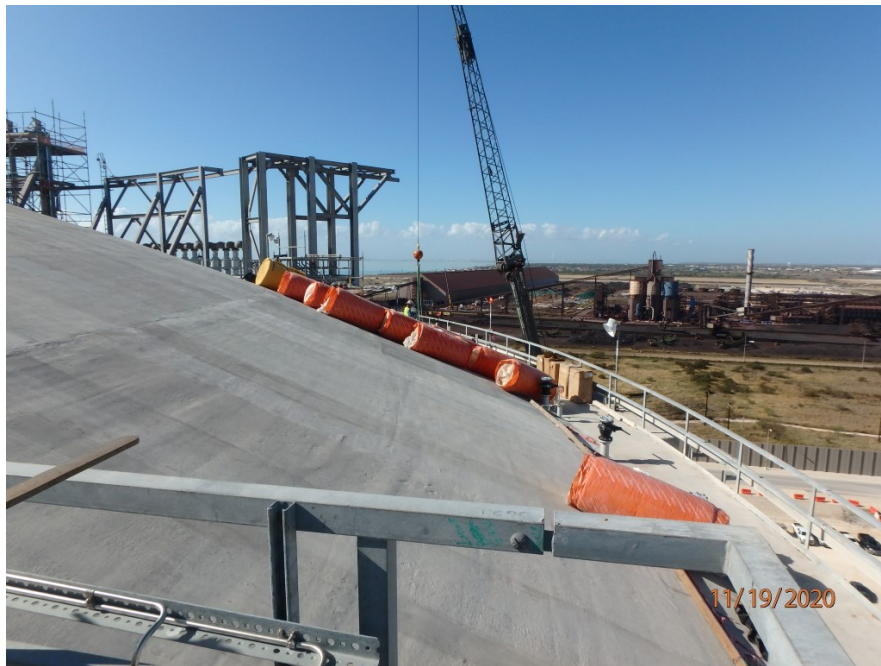
LNG Tank B - annular space blanket insulation
