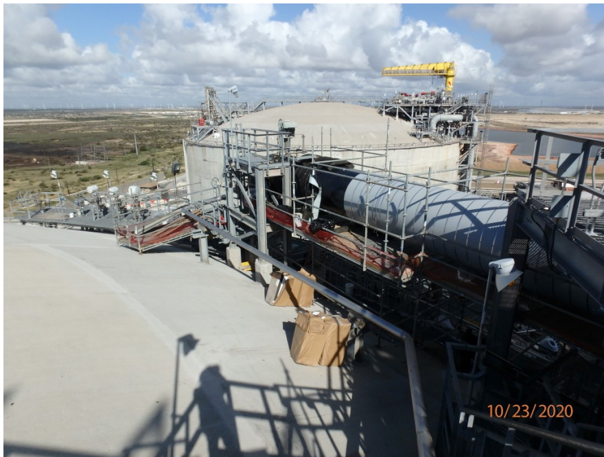
LNG Tank B piping insulation atop tank
