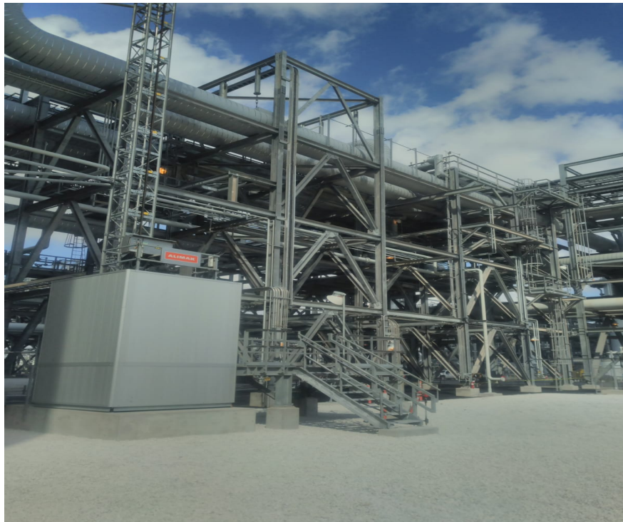
LNG Tank B permanent elevator in service
