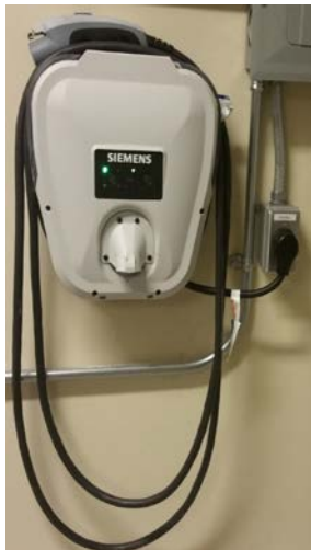
Siemens EV Charger
